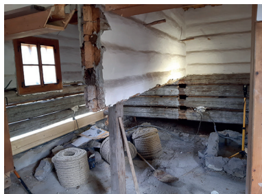
Obr. 09: Zabezpečenie statiky zrubových konštrukcií po odstránení degradovaného základového prvku po napadnutí drevo- morkou, objekt z Liptovskej Sielnice v MLD Pribylina, foto: J. Příbyl
